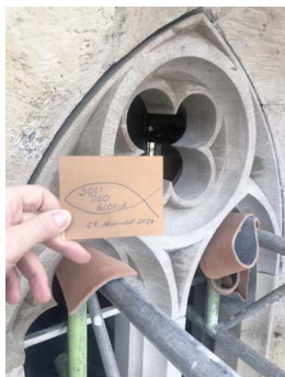
Dieser Zettel klemmt nun in der Fuge des neuen Fensters.
